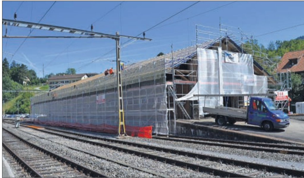
Selon l'architecte Gaël Beuret, la halle sera prête pour le 1 er octobre, date des festivités qui marqueront les 100 ans du tunnel Moutier-Granges.
